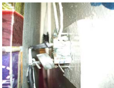
Figura 1. Tomacorrientes del refrigerador y licuadora con cables descubiertos
